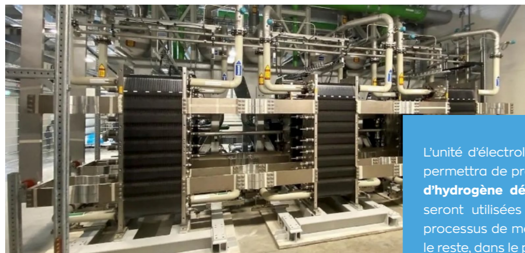
Figure 25 - un électrolyseur PEM de SIEMENS ENERGY
